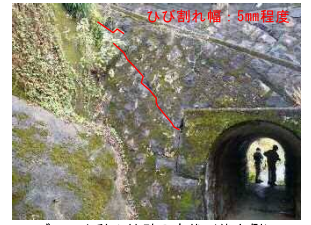
ブロック積み擁壁の変状(終点側)
