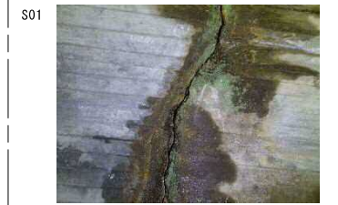
①ひび割れ
