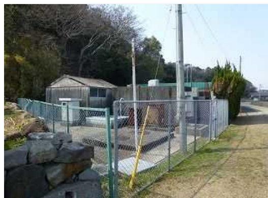
大潟ポンプ場
