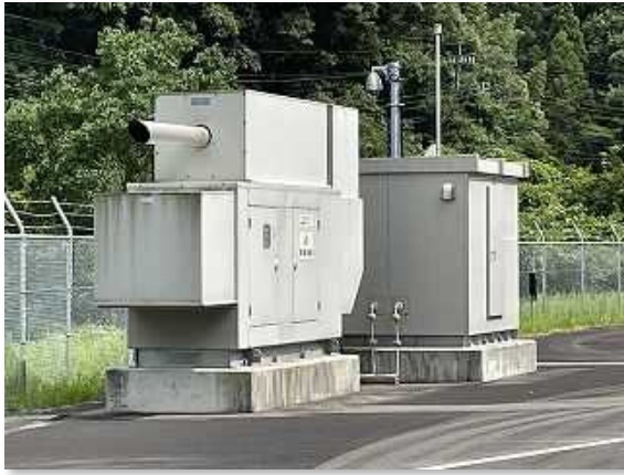
倉江浄水場 自家発電設備
