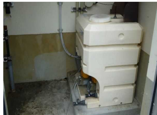
前島ポンプ場追塩設備
