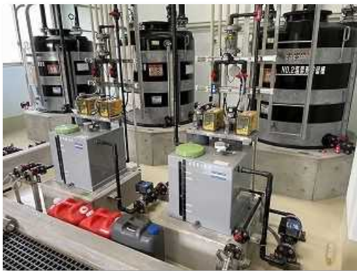
薬品注入設備
