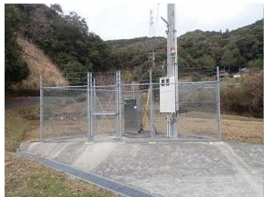
野々川増圧ポンプ場
