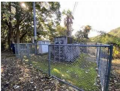
大作山ポンプ場
