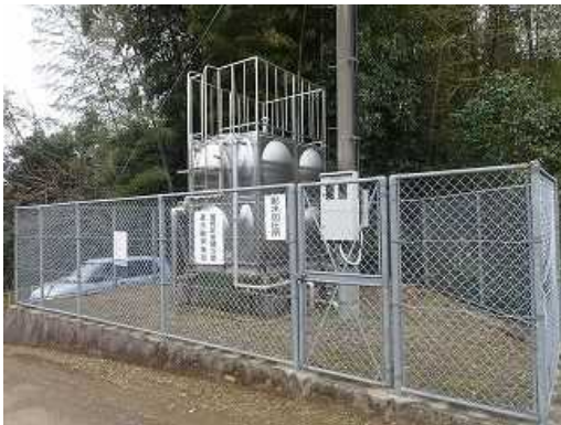
山田久保増圧ポンプ場
