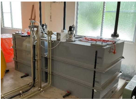
薬品注入設備
