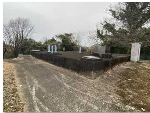
西部第2配水池
