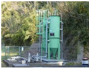
急速ろ過設備
