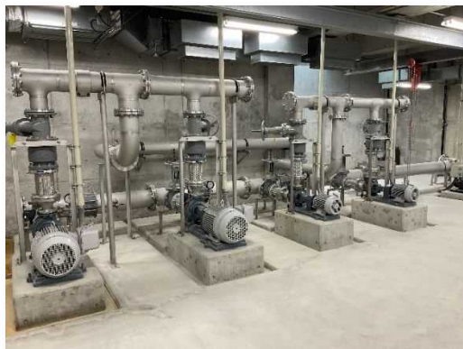
逆洗・表洗ポンプ
