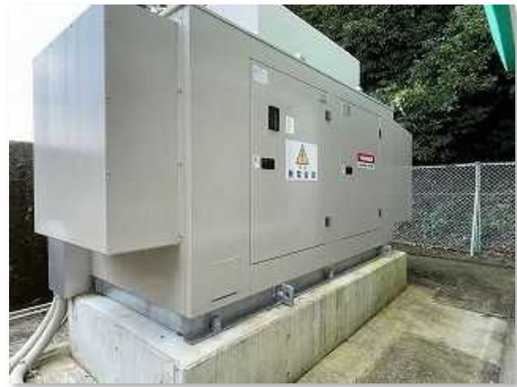
大潟ポンプ場 自家発電設備
