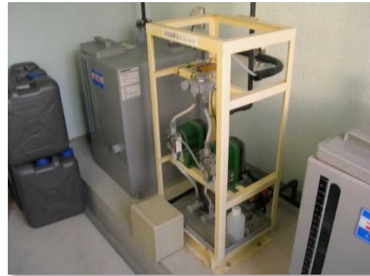
姫戸配水池追塩設備
