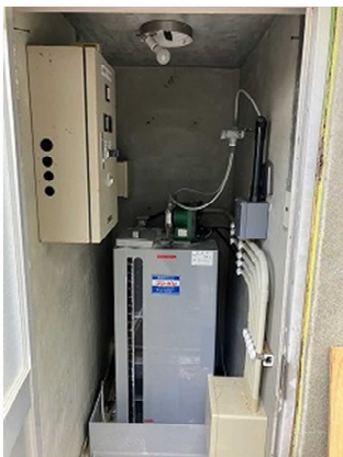
凝集剤貯留槽
