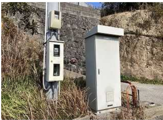
野釜ポンプ場
