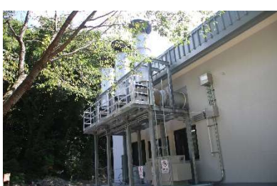
排ガス処理施設
