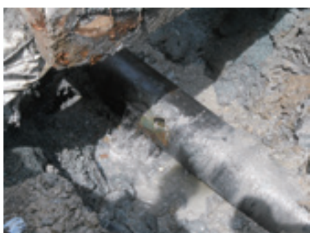
▲破損した水道管
