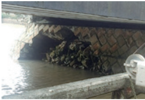
▲崩壊した石積み
