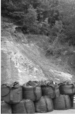
▲がけ崩れ箇所
