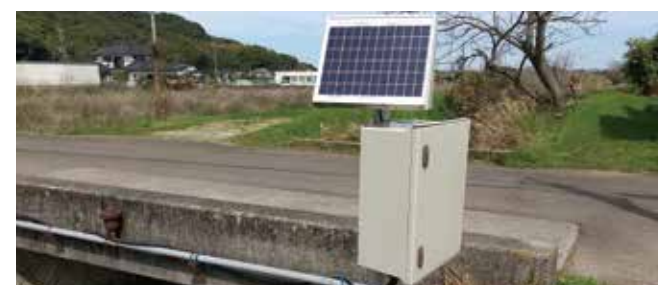
危機管理水位計(合津川)
