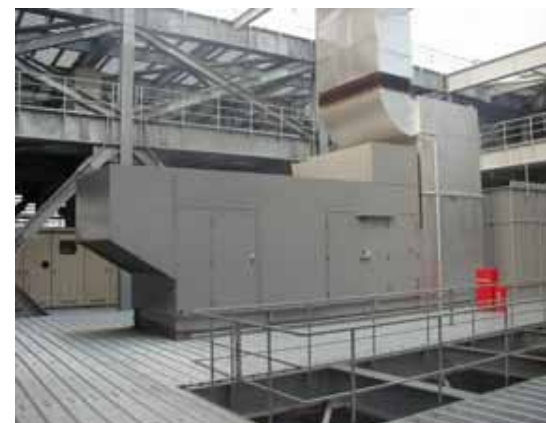
【交換局自家用発電機】
