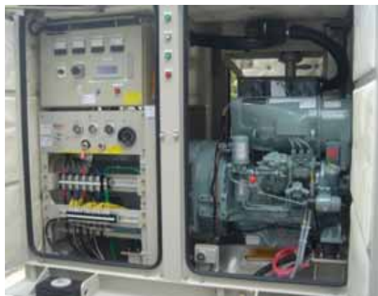
【基地局自家用発電機】
