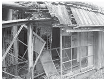
・Dランク 倒壊や建築材の飛散など危険性が高い空き家
