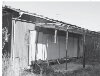
・Cランク 当面の危険性はないが、屋根や壁などの損傷が激しい空き家
