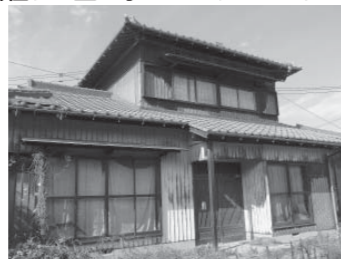
・Bランク 屋根や壁などの一部損傷は見られるが、当面の危険性はない空き家
