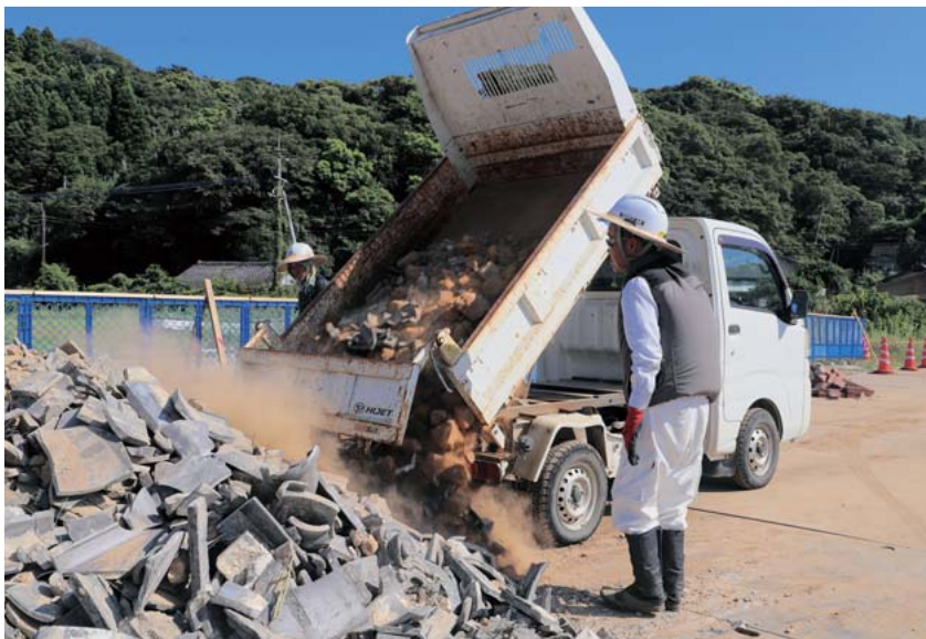
▲串漁港災害ごみ置き場 持ち込まれたがれき
