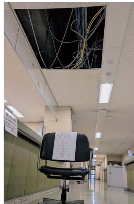
▲市役所大矢野庁舎 天井板の一部落下
