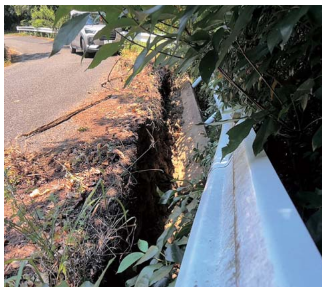
▲市道鳴川西川内線 コンクリート基礎倒壊
