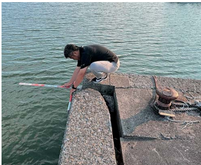
▲貝場漁港 1 号物揚場（大矢野町中）護岸部分の目地開き
