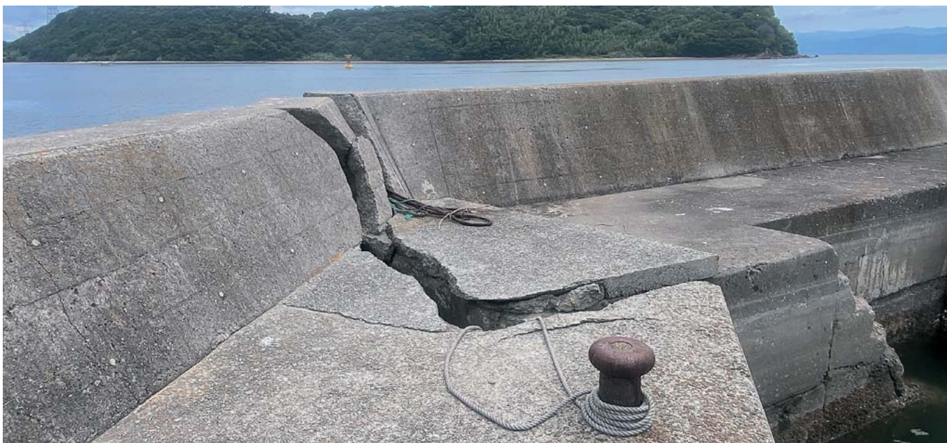
▲蔵々漁港東側防波堤（大矢野町維和）約 20cm 程度のひび割れ、目地開き
