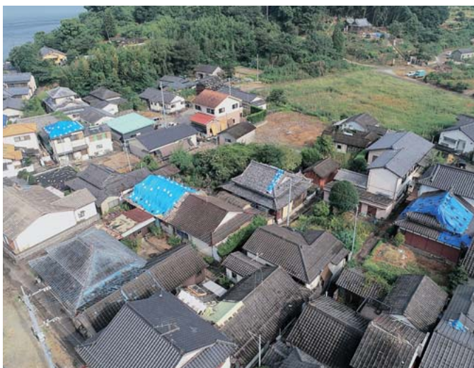
▲維和蔵々地区（大矢野町）住宅被害
