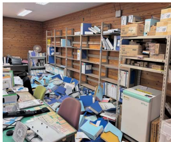
▲市役所松島庁舎執務室内 地震によって大量の書類が散乱
