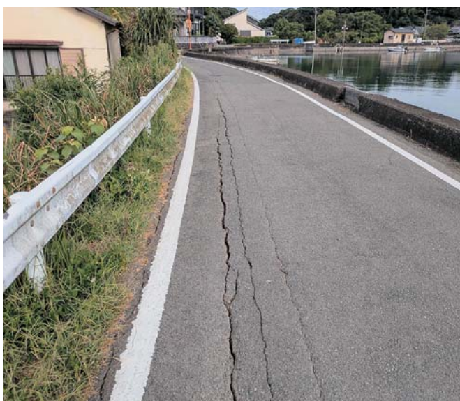
▲市道小瀬戸小平線（大矢野町中）道路のひび割れ
