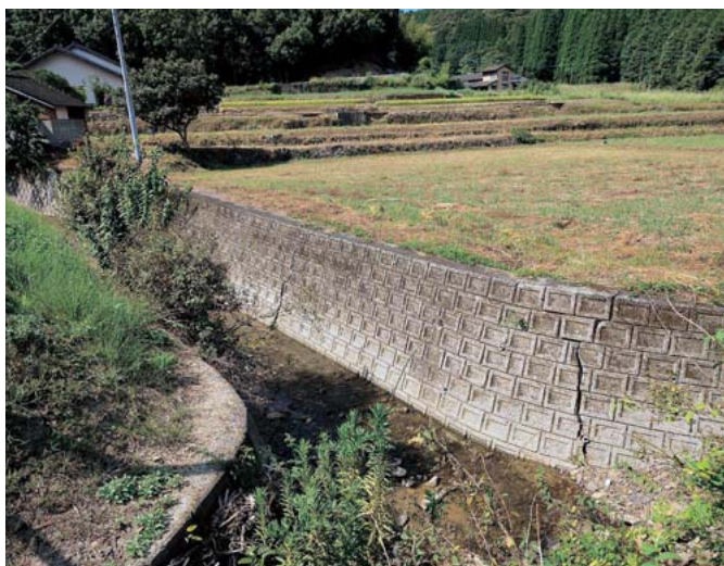
▲山浦川（松島町教良木）護岸のひび
