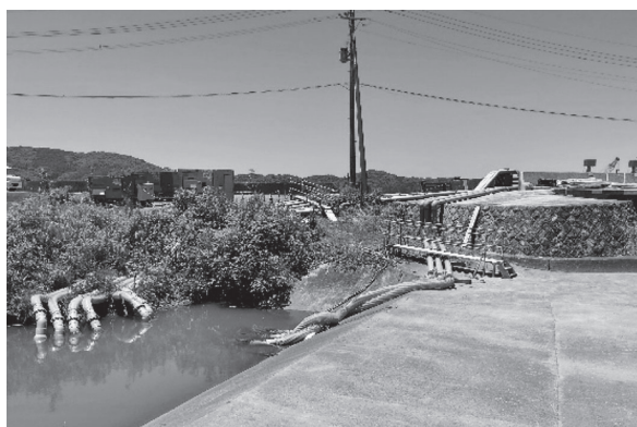
▲仮設ポンプが設置された今泉排水機場
